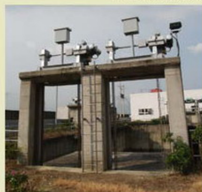
▲電動引水閘門
