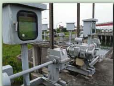
▲電動閘門設備
