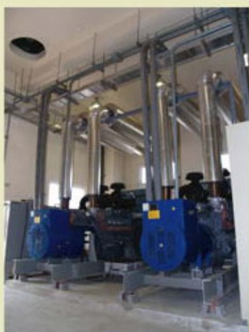
▲發電機組設備
