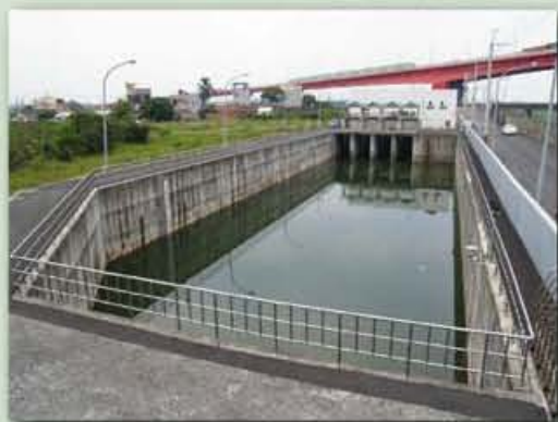
▲抽水站調節池
