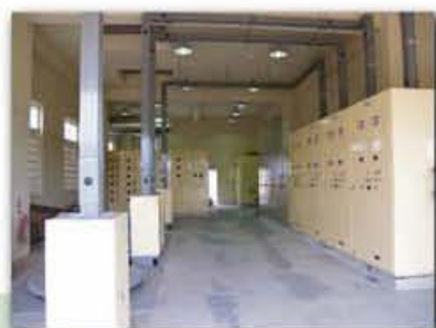
▲配電盤及匯流排
